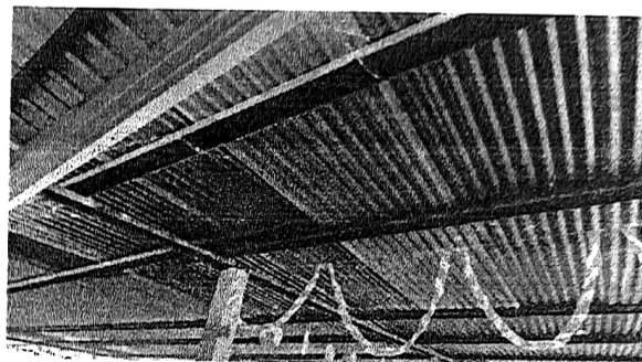
Foto 2: Necesidad de mejorar de estructura de soporte de metal, por metal
