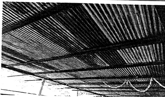
Foto1: Necesidad de mejorar instalando Estructura Portante Metálica (Tipo Portico) y cubierta de Techo con Lámina Troquelada Calibre 26.
